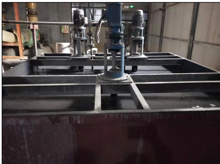
图 4-1 脱硫废水治理设施图片
