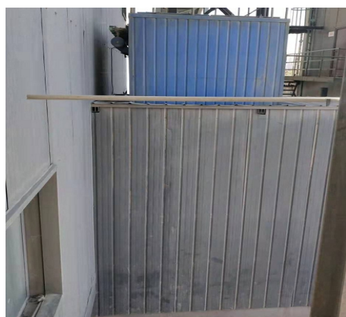
灰仓治理设施
